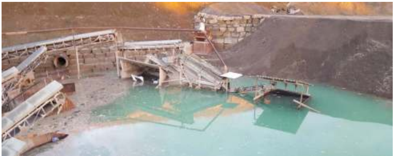
Abbildung 2: Außergewöhnlich hoher Grundwasserstand im Bereich der bestehenden Förderbänder und des Vorbrechers am 31.01.2018.
